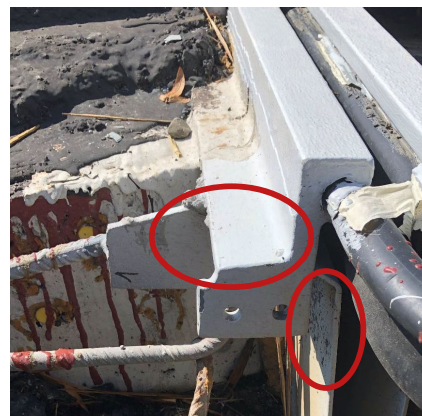
Stangenware – Abdichtungsflansch deutlich zu schmal und ohne Entlüftungslöcher kein abtauchender Schenkel (dünnes Schalblech)
