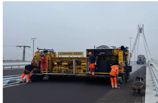
Baustelle Hochstraße Ludwigshafen 80.000 m 2 Gussasphaltschutz- und Deckschicht 2 Lagen je 35 mm MA 11 S, PmB 10/25 VL Verfahren B mit bit. Aufhellungsgestein Quarzit 2/4
